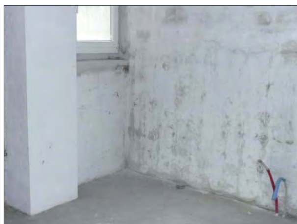
Fot. 1 | Skutek zbyt szybkiego wykonywania warstw wykończeniowych (fot. autora)
