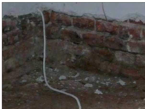
Fot. 3 | Niekiedy uszkodzenia popowodziowe są tak duże, że konieczne jest usunięcie podłogi (fot. autora)
