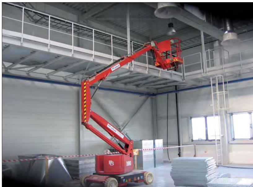
Fot. 3 | Pomost, z którego spadł poszkodowany
