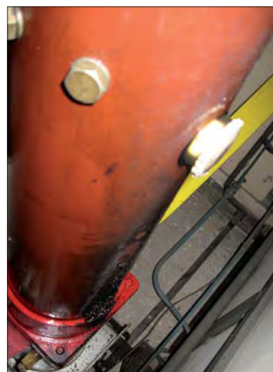
Fot. 1 | Zwarcie wystąpiło pomiędzy śrubą dolnego styku skrajnej kolumny wyłącznika MSMWP a uziemioną obudową rozdzielni
