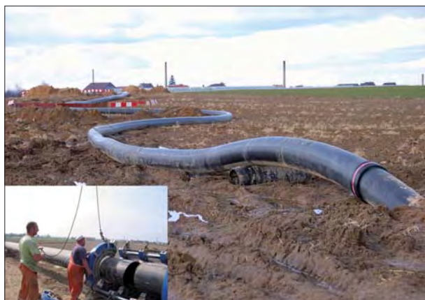
Fot. 1 | Rurociąg tymczasowy
