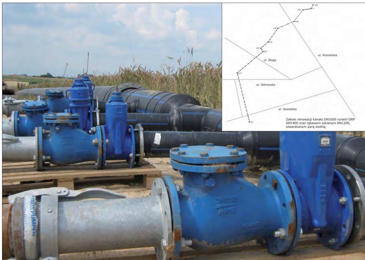
Fot. 5 | Rurociąg tymczasowy
