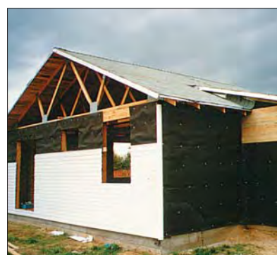
Fot. 2 | Papa zamiast wiatroizolacji
