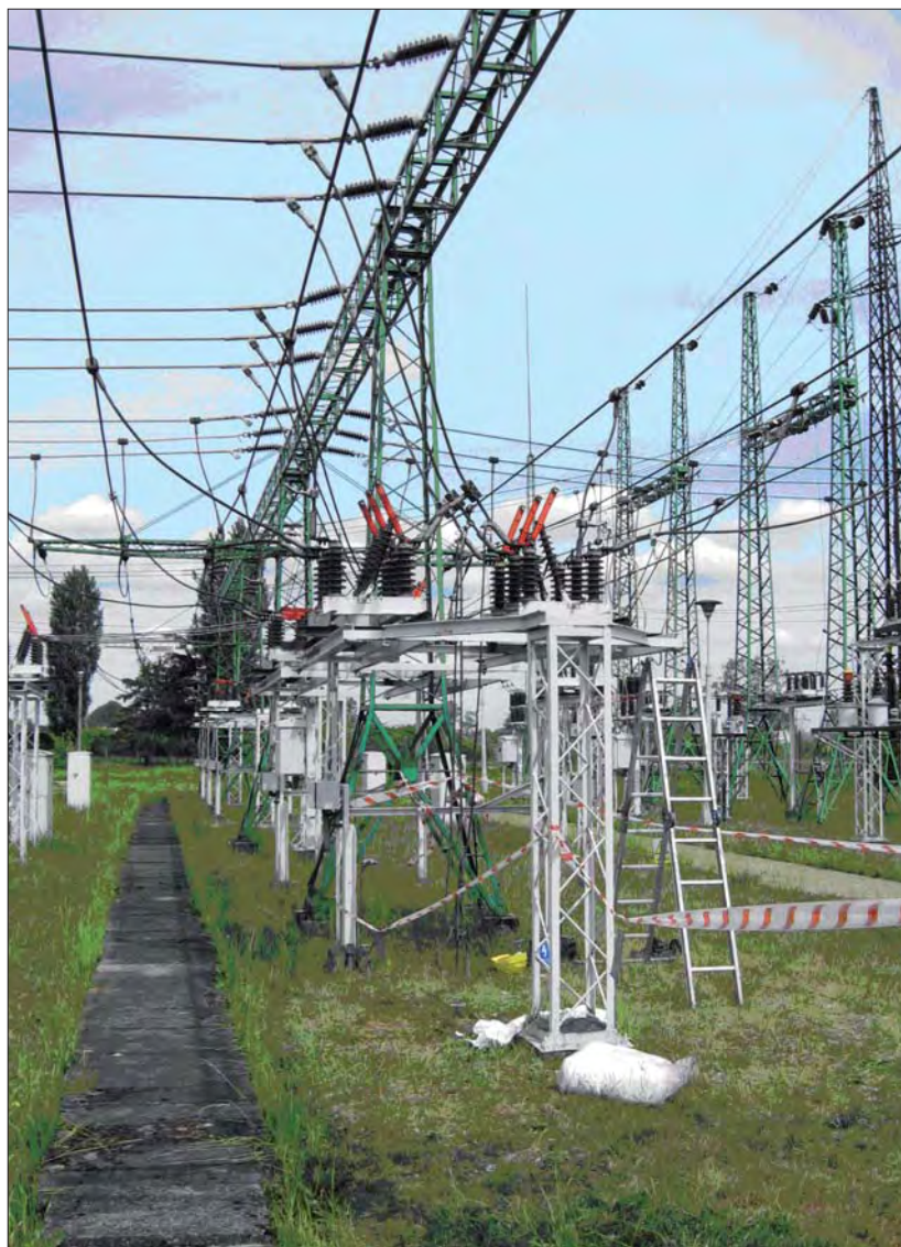
Fot. 2 | Odłącznik liniowy 30 kV w GPZ
