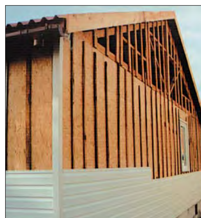
Fot. 1 | Brak wiatroizolacji
