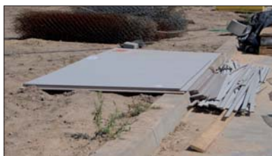
Fot. 4 Przykład niewłaściwego składowania i docinania okładzin elewacyjnych
