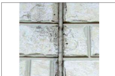
Fot. 14 Zastosowanie nieodpowiednich materiałów do uszczelnienia dylatacji
