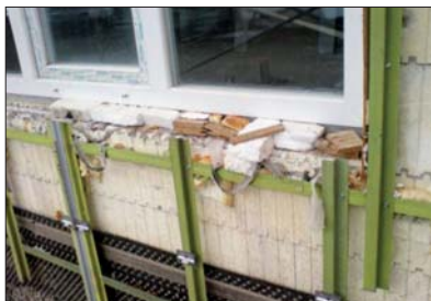
Fot. 13 Liczne pomyłki przy osadzeniu okien mające istotny wpływ na bezpieczeństwo użytkownika obiektu oraz właściwości termoizolacyjne przegrody
