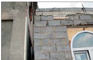
Fot. 3 Przykład podłoża murowego nienadającego się do rozpoczęcia prac elewacyjnych – niewłaściwe osadzenie okien, niska jakość prac murarskich
