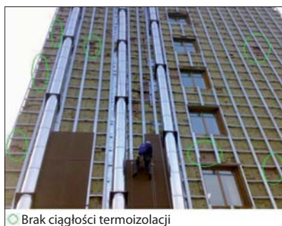
Fot. 8 | Przykład izolacji ściany z dużymi fragmentami nieciągłości
