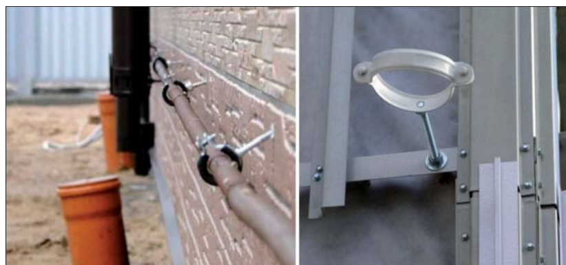
Fot. 16 Przykłady niedopuszczalnego montażu elementów instalacji oraz odwodnienia do okładzin i rusztu
