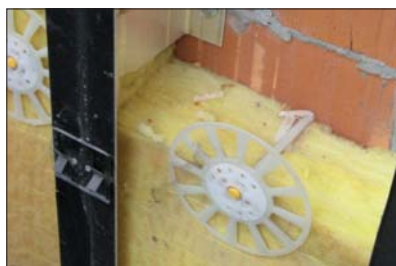
Fot. 9 | Zastosowanie nieodpowiednich ze względu na wymagania ppoż. łączników mechanicznych na wysokości +26 m
