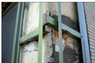
Fot. 7 | Przykład niewłaściwego wykonania podkonstrukcji, brak spełnienia podstawowych wymagań w zakresie bezpieczeństwa użytkowania oraz trwałości
