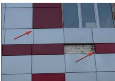
Fot. 15 Rażące odchylenia przebiegu spoin od linii prostej; elewacja została zamontowana bez termoizolacji
