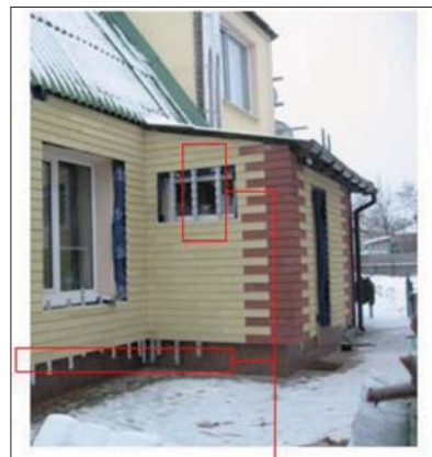
Fot. 17 Występujące fragmenty rusztu na zgłoszonej do odbioru elewacji wentylowanej
