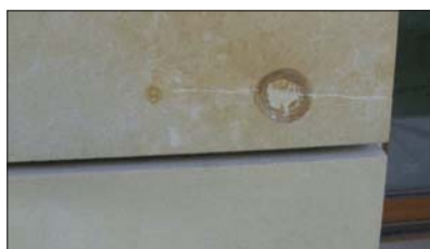
Fot. 5 | Uszkodzona okładzina kamienna
