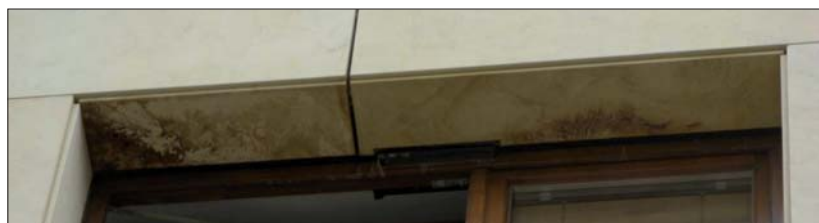
Fot. 12 | Trwałe zacieki na okładzinach spowodowane brakiem właściwego odprowadzenia wody w pasie nadokiennym
