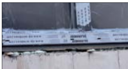
Fot. 4. Montaż, który nie był kwestionowany przez klienta – brak uszczelnienia pod oknem, brak klocków podporowych
