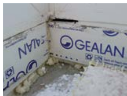
Fot. 6. Montaż okien narożnikowych, odwrócone profile podokienne, dziura pod oknem, dziura w narożniku
