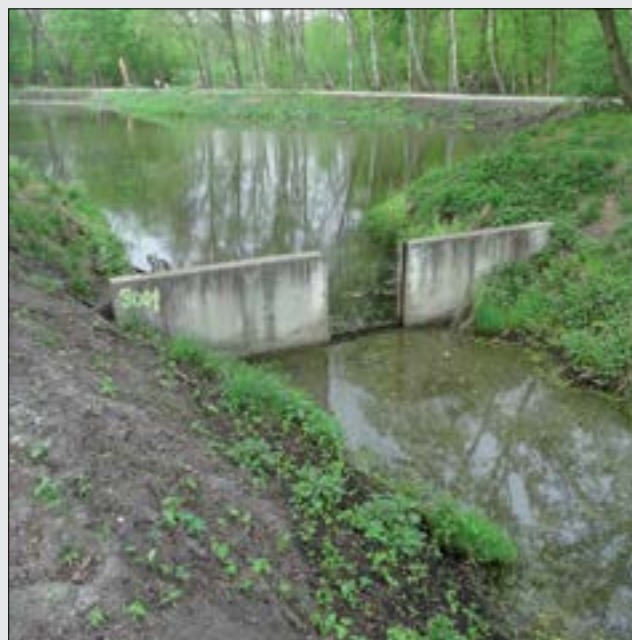
Zamknięcie na rowie pod szandory
