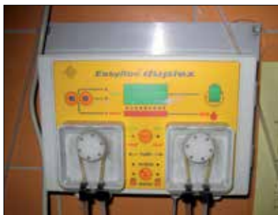
Fot. 8 | Zespół dozowania koagulantu za pomocą pompy wężykowej w instalacji po remoncie
