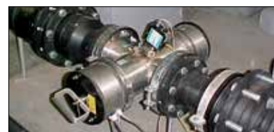
Fot. 22 | Lampa UV multifalowa zabudowana w instalacji wody basenowej
