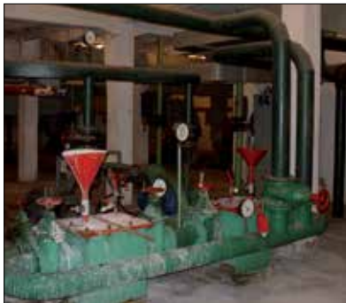
Fot. 7 | Dozowanie koagulantu do instalacji wody basenowej przed remontem
