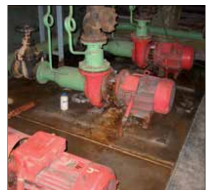
Fot. 5 | Zespół pomp wody basenowej przed remontem
