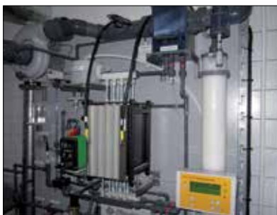
Fot. 13 | Przykład zespołu elektrolizy membranowej NaOCl na basenie po remoncie
