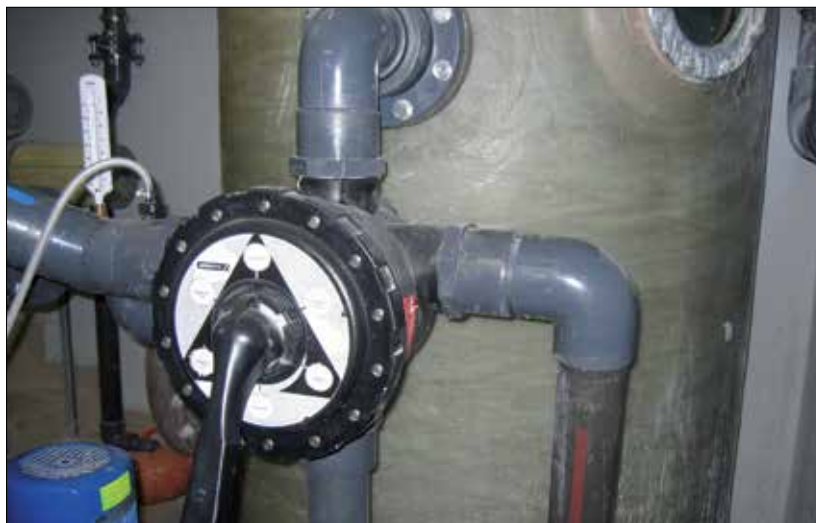
Fot. 1 | Zespół filtrów ciśnieniowych dla basenu po remoncie z zaworem sześciobudowym
