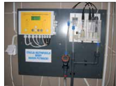
Fot. 11 | Zespół do pomiaru i regulacji pracy pomp dozujących na basenie po remoncie
