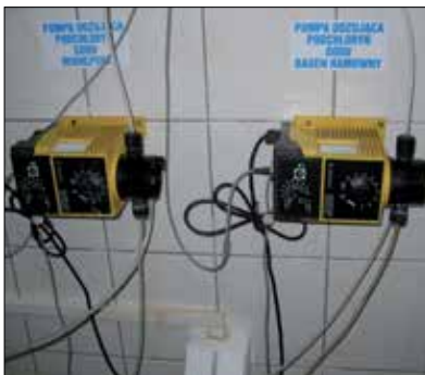
Fot. 12 | Przykład zespołu membranowych pomp dozujących NaOCl na basenie po remoncie
