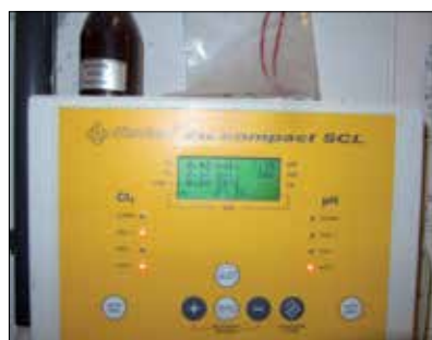
Fot. 16 | Zespół do pomiaru chloru wolnego, chloru związanego, pH, redox na basenie po remoncie
