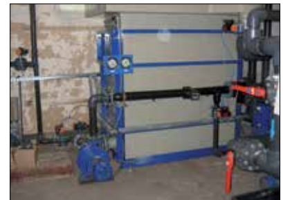
Fot. 4 | Filtr podciśnieniowy CAPTURA w podbaseniu
