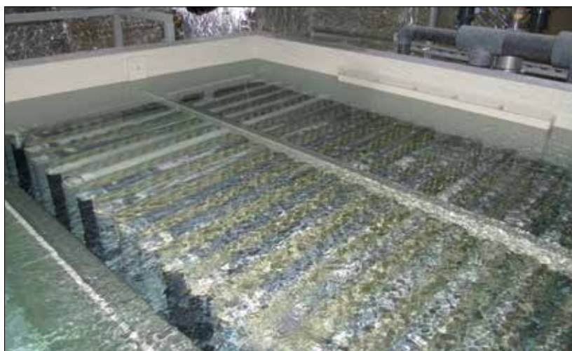
Fot. 2 | Otwarty filtr podciśnieniowy z namywaną ziemią okrzemkową
