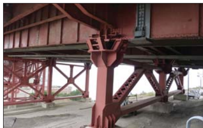
Fot. 7 | Widok nowo zmontowanych podpór pośrednich części dojazdowej. Widoczny sposób wzmocnienia blachownicowych dźwigarów głównych na czas wykonywania przebudowy podpór stalowych
