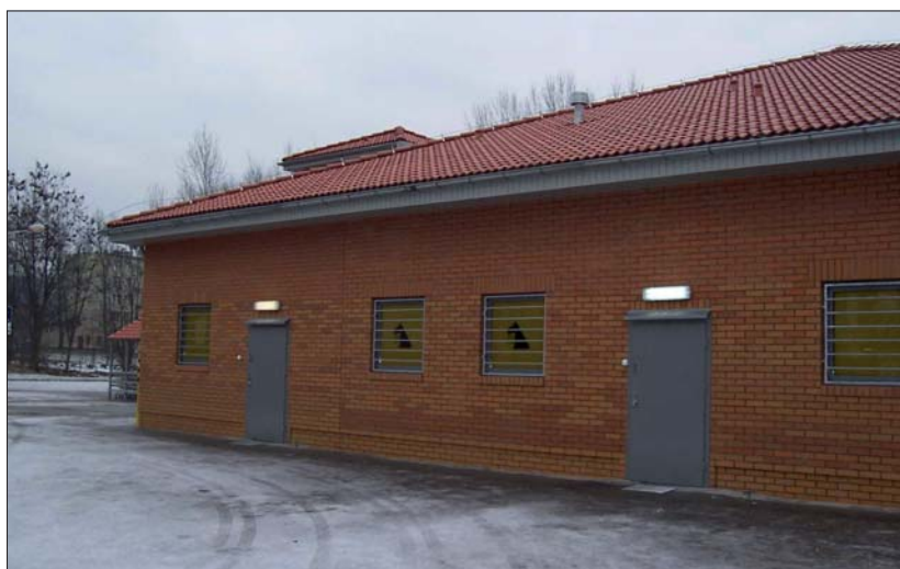
Fot. 4 | Plamy kolorystyczne spowodowane brakiem mieszania cegieł na elewacji podczas ich murowania
