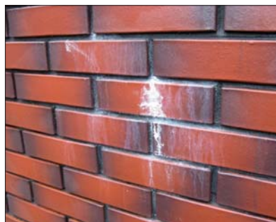
Fot. 5 | Przykład wykwitwu solnego
