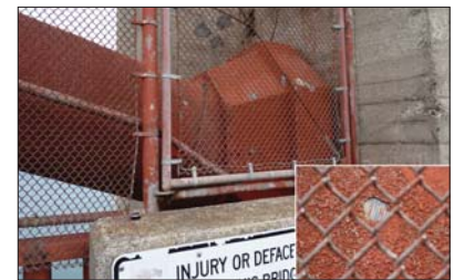
Fot. 12 | Ogólny widok zakotwienia głównych lin nośnych – zły stan powłok antykorozyjnych
