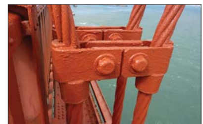
Fot. 13 | Szczegół elementów spinających wieżak. Widoczny obecny stan powłok malarskich
