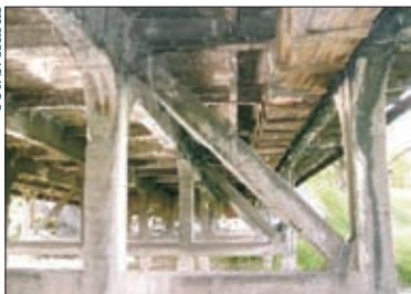
Fot. 1 | Widok na skorodowany spód pomostu mostu przy ul. Zamojskiej
