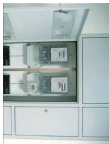
Fot. 3 | Rozdzielnica piętrowa pomiarowa (u góry liczniki indukcyjne, u dołu liczniki elektroniczne przedpłatowe) – Aparator
