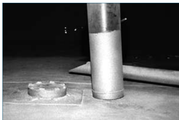
Fot. 4 | Położenie słupa podpierającego dach po przemieszczeniu się jego dolnej końcówki poza łożysko – widok ogólny
