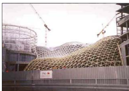
Fot. 38. Pofalowany szklany dach „Złoty Tarasów” w Warszawie, podparty konstrukcją stalową wielopunktową (budowa)
