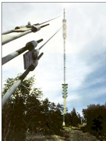
Fot. 34. Przykład masztu radiowego z odciągami stalowymi
