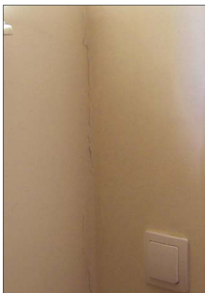
Fot. 4. Rysa na styku ściany nośnej i działowej
