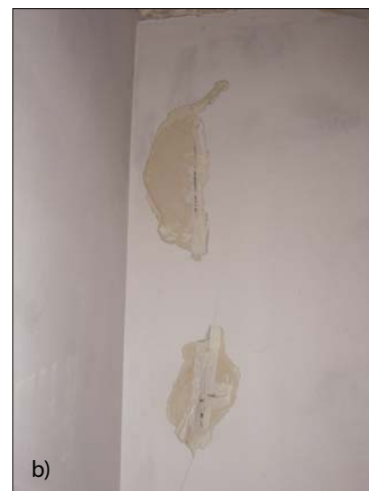
Fot. 3. Zarysowania spowodowane odkształceniami termicznymi i skurczowymi: a) rysa na elewacji, b) odkrywka wewnątrz pomieszczenia – rysy wzdłuż niewypełnionych spoin czołowych
