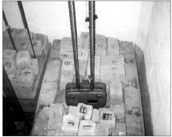
Fot. 3. Przeciwwaga w budynku stacji Kuźnice
