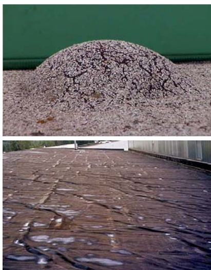
Purchle dachowe oraz sfaldowania na powierzchni dachu bez systemu wentylacji.
