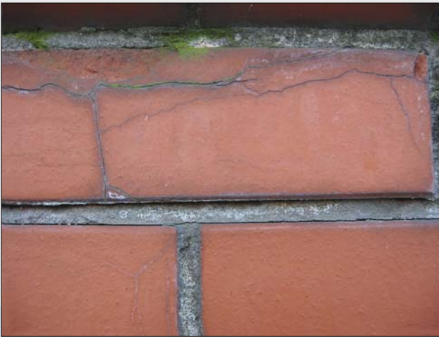
Fot. 2. Zaprawa cementowa z domieszką napowietrzającą. Widoczna jest utrata przyczepności zaprawy do podłoża.
