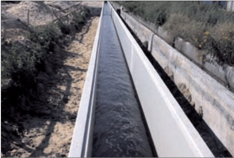
Fot. 3 | Oczyszczalnia ścieków Sitkówka koło Kielc – powłokowe zabezpieczenie żelbetonowych zbiorników osadników wstępnych i kanałów odpływowych. Ze względu na agresję spowodowaną zanieczyszczeniami obecnymi w ściekach komunalnych jako powierzchniową ochronę betonu wybrano żywicę epoksydową (na ścianach zbiorników) oraz materiał epoksydowo-bitumiczny (na dnie zbiorników). Kanały odpływowe zabezpieczone zostały wewnątrz żywicą epoksydową. Podstawowy aspekt w tego typu obiektach to trwałość zabezpieczenia wymagana ze względu na charakter i przeznaczenie zbiorników oraz wpływ na środowisko i ekologię rejonu.
