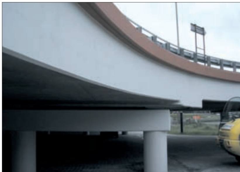
Fot. 1 | Dworzec Łódź Kaliska – remont estakady. Powierzchniowa ochrona betonu po pracach renowacyjnych wykonana została z elastycznej farby akrylowej. Trwałość naprawy i ochrony takiego obiektu jest kluczowa chociażby ze względu na wysoki koszt zamknięcia i wyłączenia z eksploatacji na czas remontu.
