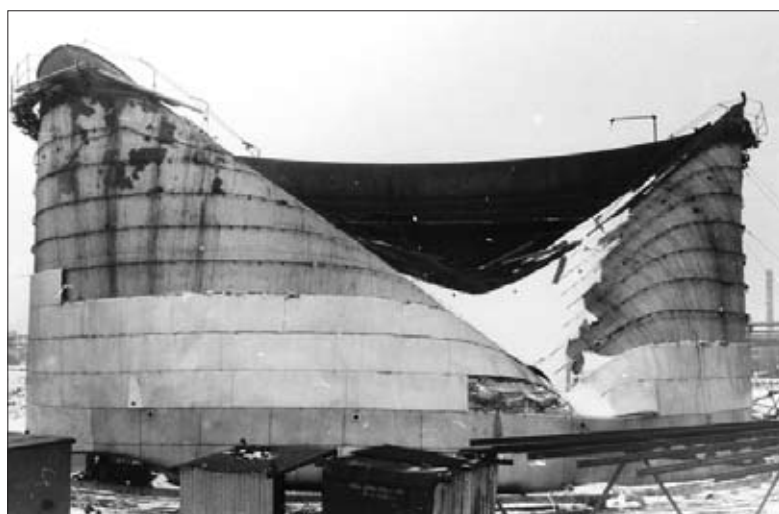
Fot. 3 | Płascz zbiornika załamany podczas konstrukcji nośnej dachu
