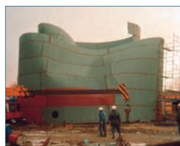
Fot. 4 | Uszkodzony działaniem wiatru zbiornik dwupłasczowy (na pierwszym planie niezamontowane elementy pierścienia wiatrowego)
