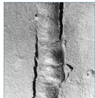
Fot. 6 | Pęknięta spoina pionowa w płaszczu zbiornika
