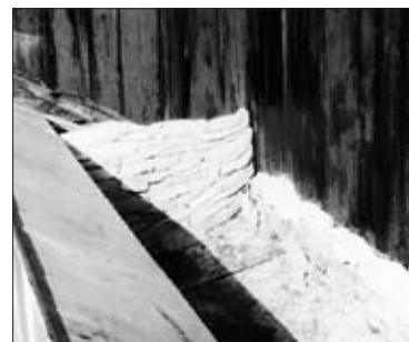
Fot. 7 | Grodzka z gliny ograniczająca strefę chronioną – wykonano ją pomiędzy burtą pianową na dachu pływającym a płaszczem zbiornika
