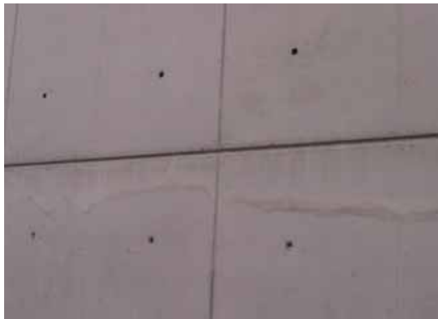
Fot. 10. Tzw. firanki będące skutkiem wykonywania elementów w poziomych sekcjach i nieuwzględnienia skurczu dolnej warstwy betonu
