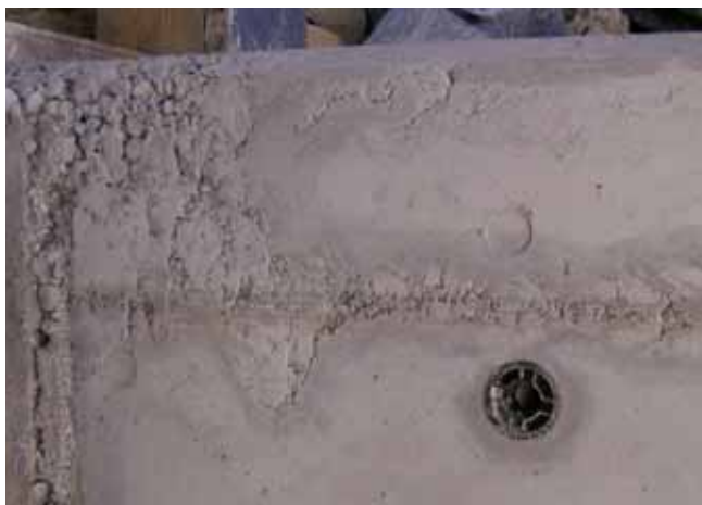
Fot. 9. Tzw. gniazda żwirowe powstałe w wyniku nieszczelności deskowania
