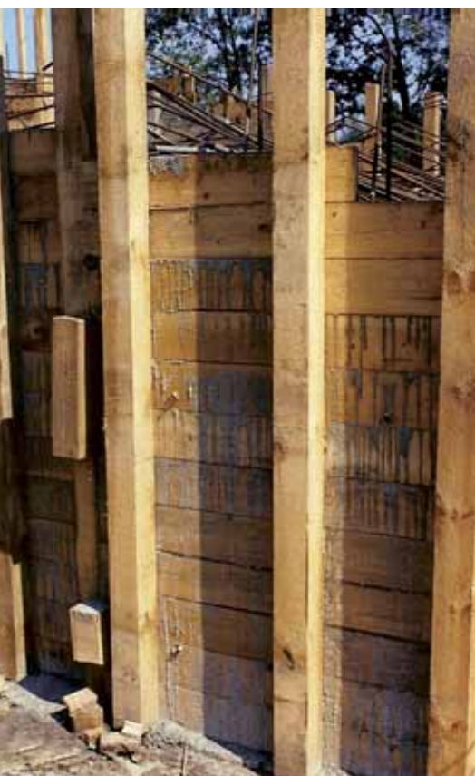
Fot. 7. Wycieki spowodowane nieprawidłowym montażem deskowania
