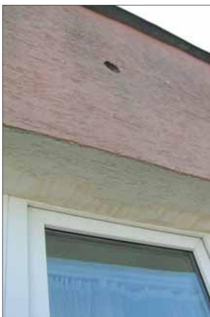
Fot. 3. Ościeżnica okna całkowicie zakryta izolacją ościeża
