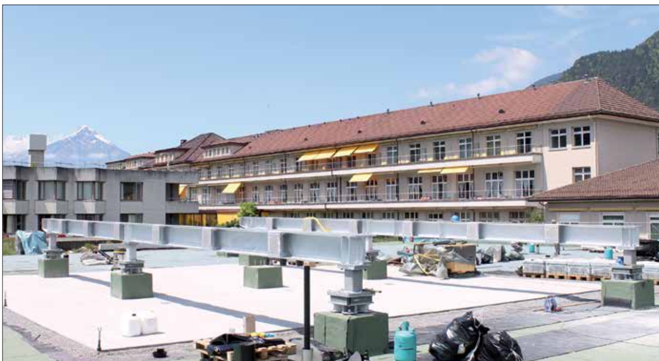
Fot. 5. Wibroizolatory w szpitalu Interlaken (Szwajcaria)
