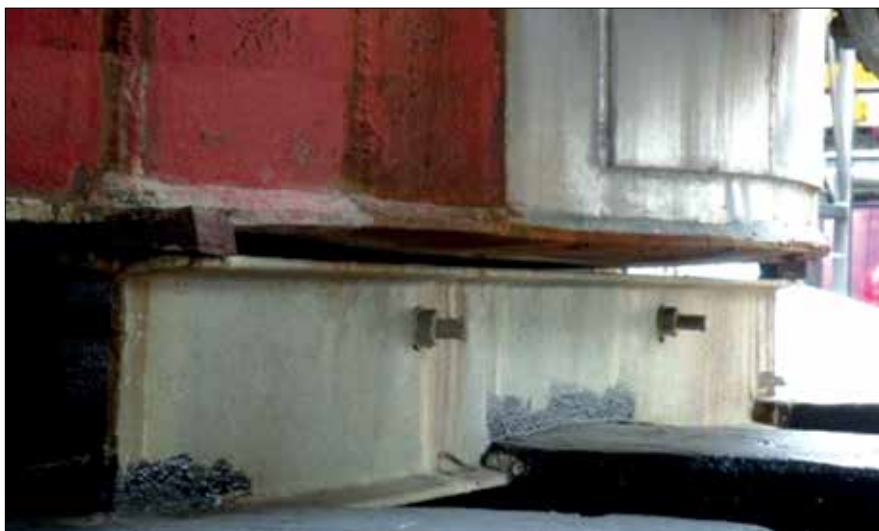
Fot. 5. Wybrzuszenie dna wieży i kliny podpierające pobocznice
