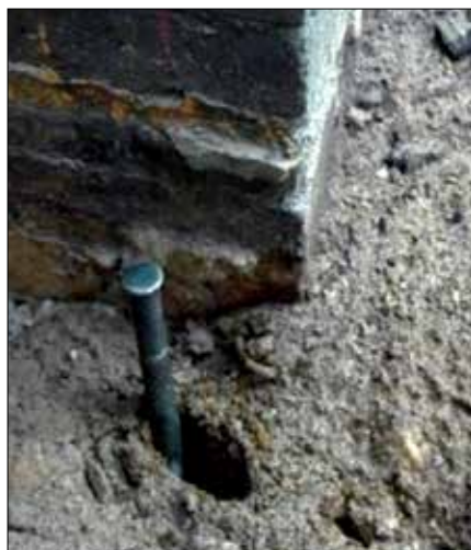
Fot. 6. Wpływ wieloletniego działania kwasu na beton podpór zbiorników
