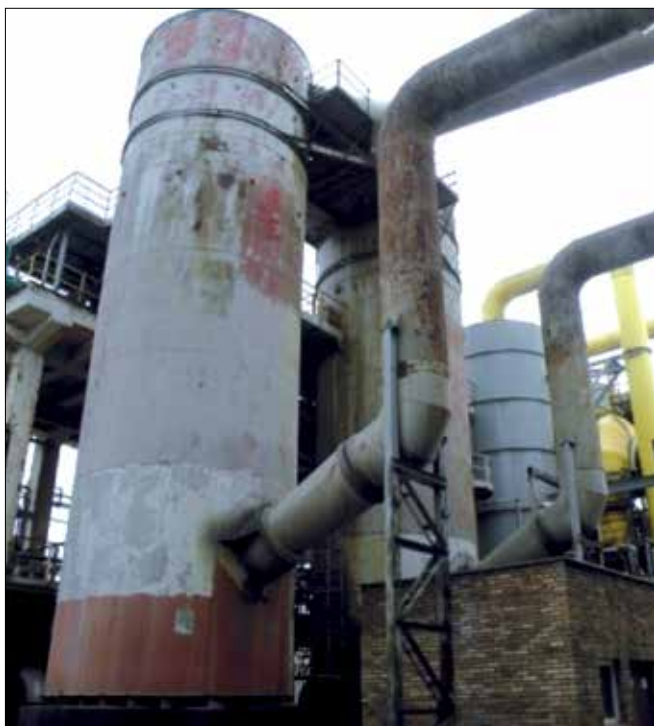
Fot. 1. Baterie zbiorników – wież suszących i absorpcyjnych
