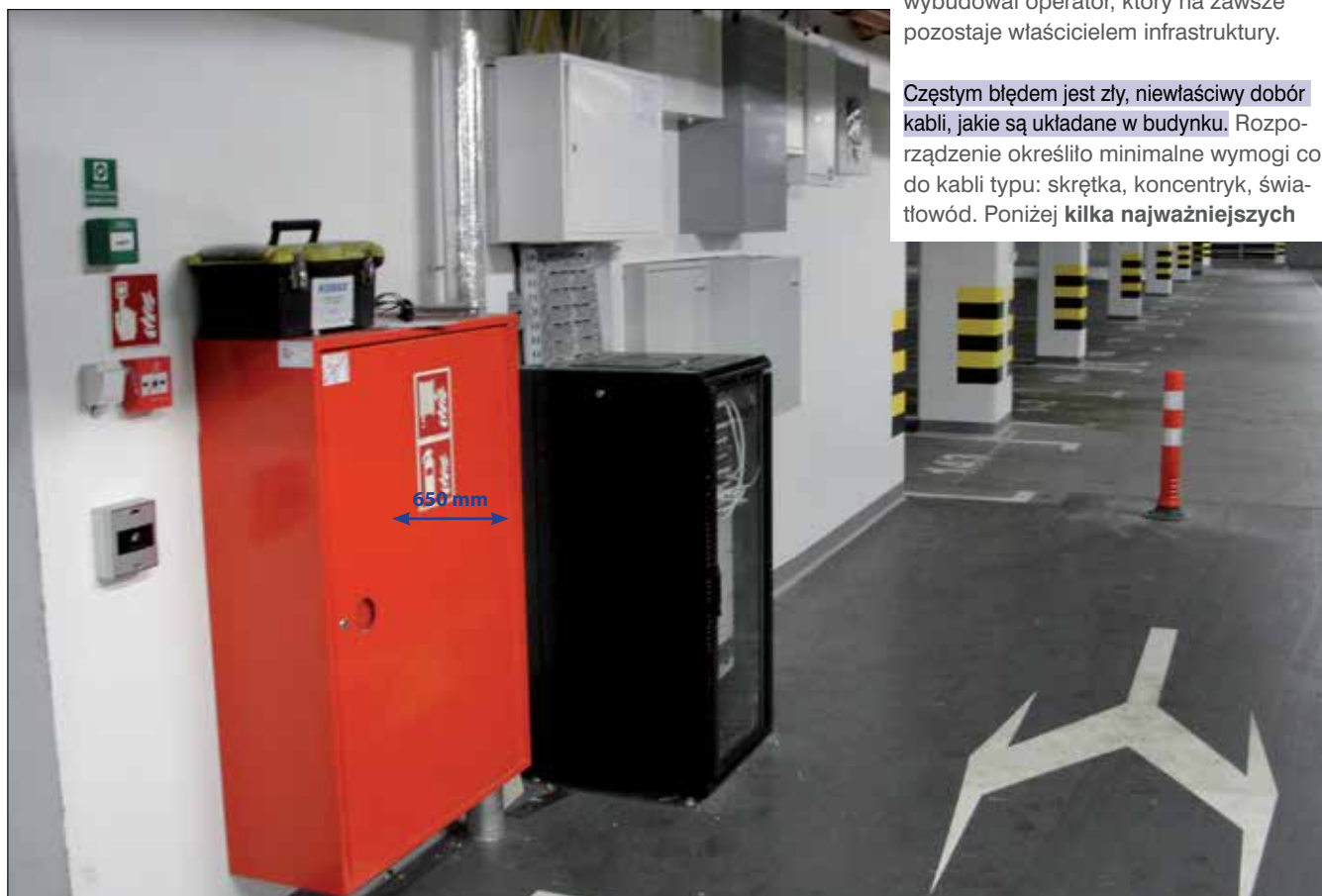
Fot. 4. Szafka RACK 19" punktu styku dla operatorów telekomunikacyjnych stojąca w drodze przejazdowej w garażu podziemnym
