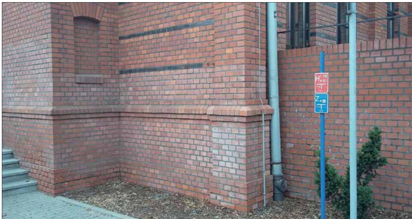
Fot. 2. Wykwit pierwotny na murze licowym powstały po pracach remontowych (fot. autor)
