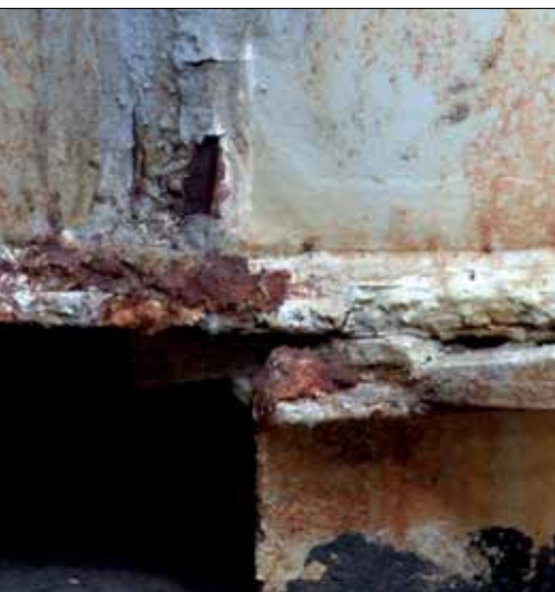
Fot. 4. Korozja spoiny łączącej płaszczy z dnem
