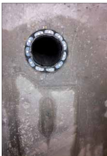
Fot. 6. Przyłącze teletechniczne do budynku
