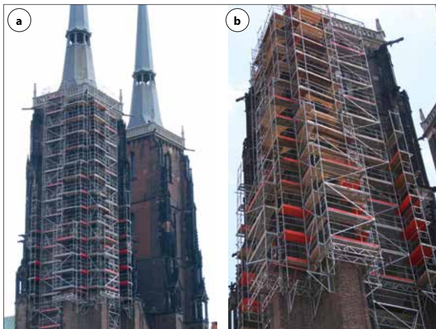
Fot. 2. Rusztowanie wspornikowe wielopomostowe posadowione na konsolach budowlanych – katedra we Wrocławiu: a) widok rusztowania, b) szczegół podwieszenia (Multiserwis)
