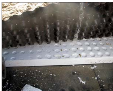
Fot. 1 | Brak geowłókniny powoduje zniszczenie termoizolacji
