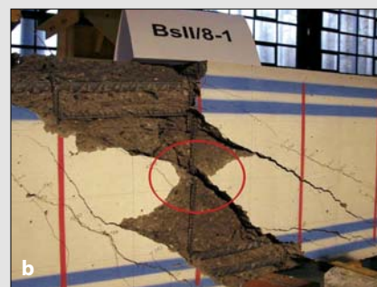
Fot. 4 Elementy po zniszczeniu
