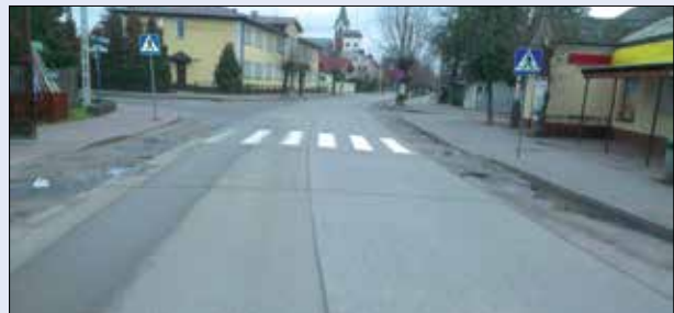
Fot. 3 Nawierzchnia betonowa w miejscowości Wilga po 55 latach eksploatacji (fot. autor, 11.11.2015 r.)
