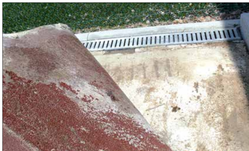
Fot. 3 | Odspojenie nawierzchni od podbudowy
