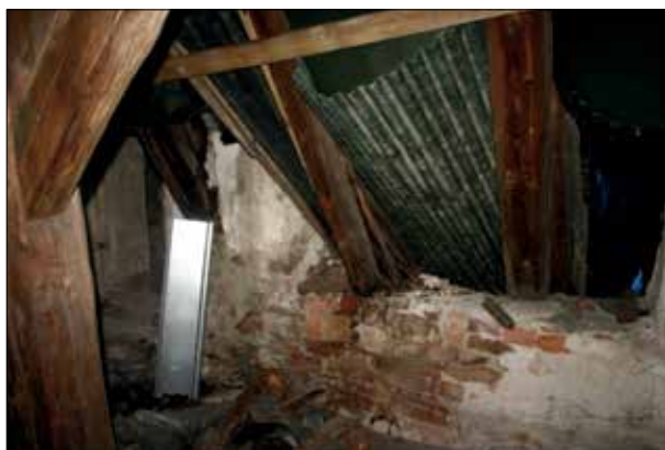
Fot. 2 | Uszkodzenia krokwi w wyniku zawilgocenia oraz korozji biologicznej
