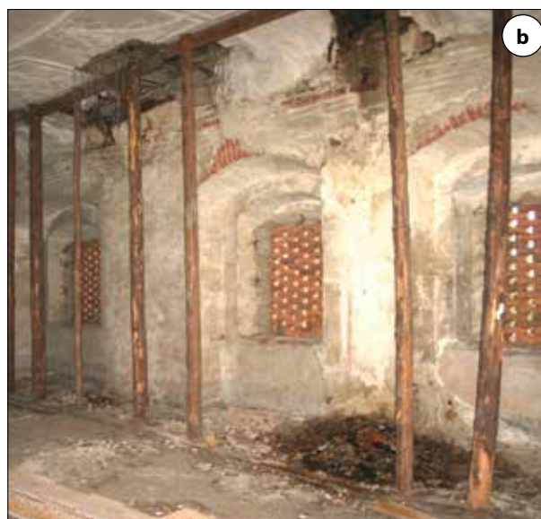
Fot. 4 | Uszkodzenia stropów kolejnych kondygnacji wywołane lokalnym oddziaływaniem wody: a) uszkodzenia stropu trzeciej kondygnacji, b) uszkodzenia stropu drugiej kondygnacji
