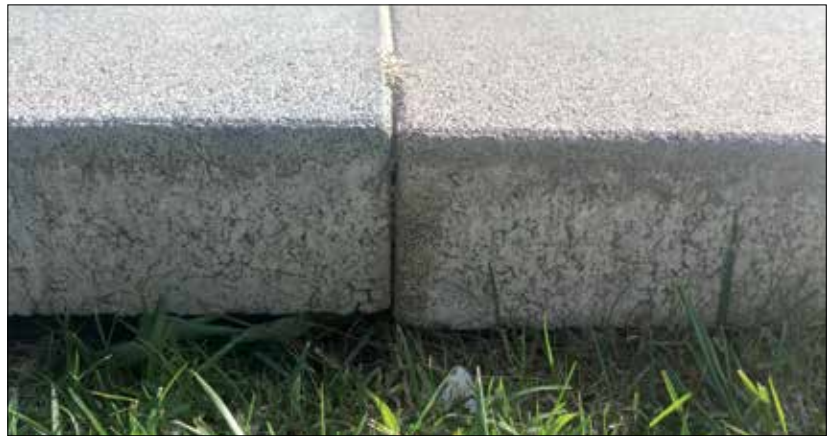
Fot. 5 | Tolerancje wykonania betonowych płyt brukowych
