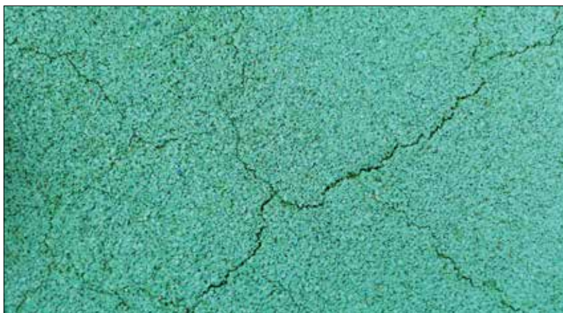
Fot. 2 | Liczne spękania nawierzchni
