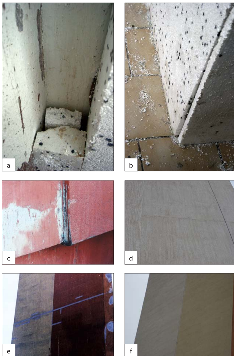
Fot. 2 | a, b – bezmyślne ułożenie płyt styropianowych gwarantujące późniejsze mostki termiczne, c – bezmyślne wykończenie strefy cokolowej, d – skutki wyjątkowej niestaranności przy wykonywaniu tynku strukturalnego, e – takie uszkodzenia termoizolacji mogą mieć kilka przyczyn, f – ... jednak naprawa musi uwzględniać przyczyny uszkodzeń, a nie próbować maskować skutki
