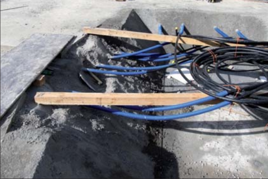
Fot. 2 Instalacja do odzysku ciepła odizolowana od płyty dennej styropianem
