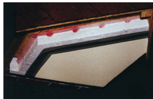
Fot. 1 | Docieplenie ścian drewnianych. Istotą systemu jest wiatroizolacja ułożona bezpośrednio na podłożu drewnianym, styropian z ryflowanym spodem oraz listwa startowa z otworami (model systemu – Dryvit)
