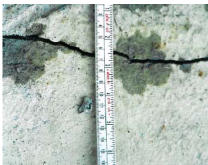
Fot. 3. Pęknięcie w strefie wieńca górnego zbiornika
