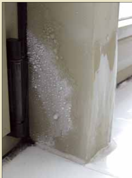
Fot. 4. Obłoczenie słupka ściany osłonowej metalowo-szklanej w jednym z budynków ITB
