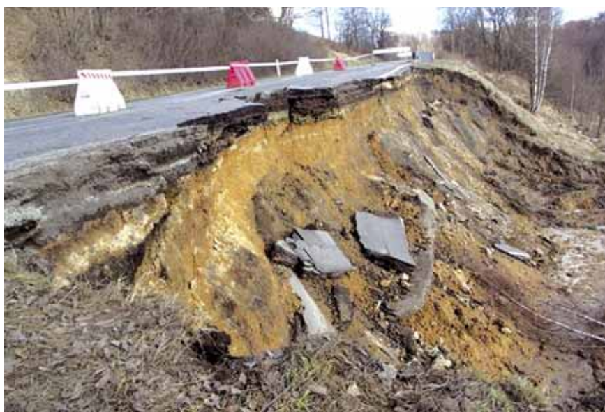
Fot. 1. Osuwisko ok. 6 m skarpy drogi krajowej w Nowej Rudzie spowodowane błędną oceną warunków geotechnicznych nawodnionego podłoża
