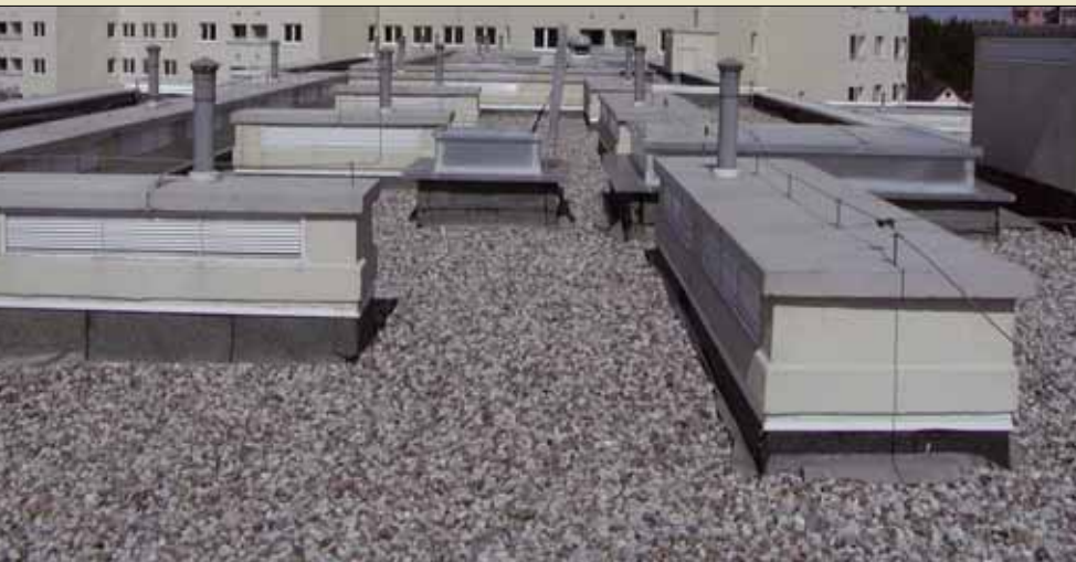
Fot. 2. Niezgodne z przepisami wyloty kanałów wentylacyjnych
