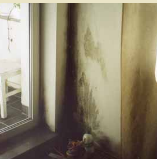
Fot. 3. Pleśń na ścianach nad słupami żelbetowymi parteru
