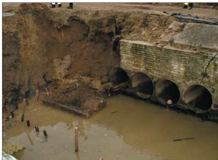
Mur starego przepustu; widać wyraźne pęknięcia, w rogu widoczne paliki na palisady
