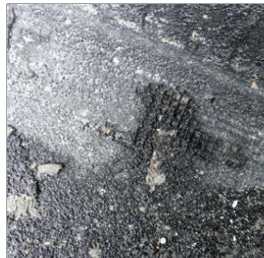
Fot. 5 | Widoczne oczka siatki świadczą o pocienieniu warstwy hydroizolacji (fot. autor)
