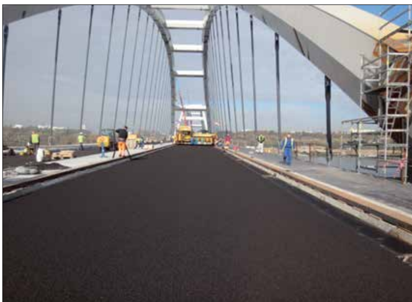
Fot. 3 | Układanie asfaltu lanego na moście przez Wisłę w Toruniu (archiwum Pont-Projekt)
