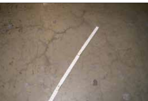
Fot. 4 | Odpryski posadzki spowodowane korozją mroзовą kruszywa
