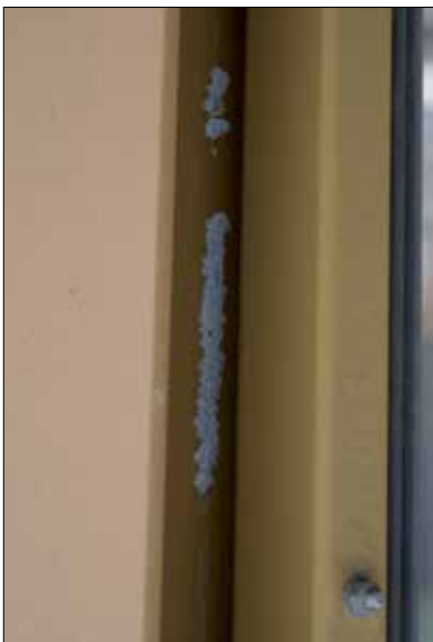
Fot. 12 | Uszkodzenie mechaniczne wewnętrznej powierzchni słupa w trakcie montażu kasety
