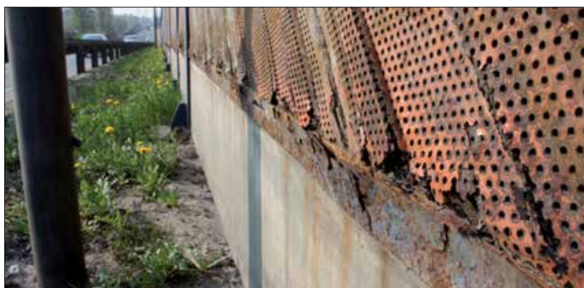
Fot. 6 | Ubytki korozyjne na kasetach ocynkowanych
