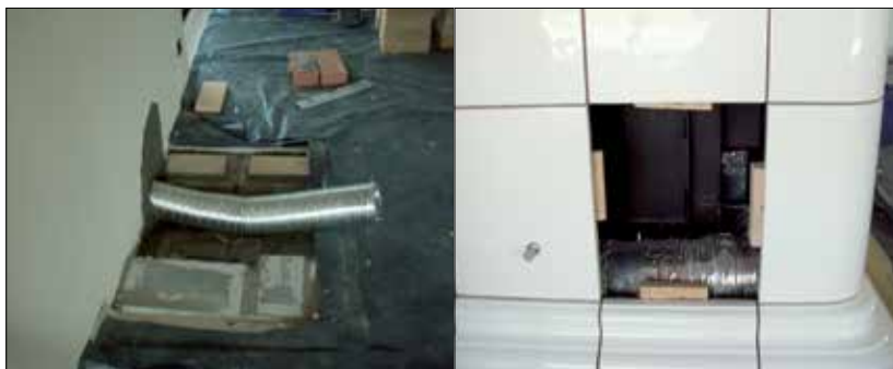
Fot. 4 | Nawiew doprowadzający powietrze bezpośrednio do paleniska (źródło: blog.kominki-batura.pl)
