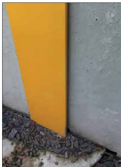
Fot. 4 | Posadowienie słupa bez zabezpieczenia przed bezpośrednim kontaktem z gruntem
