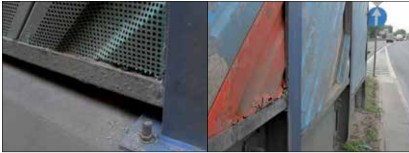
Fot. 7 | Ubytki korozyjne na kasetach aluminiowych
