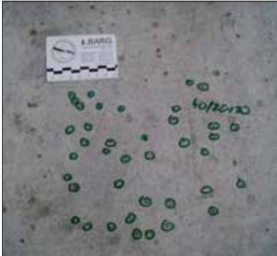
Fot. 6 | Odpryski posadzki spowodowane reakcją alkaliczną kruszywa posypki z cementem
