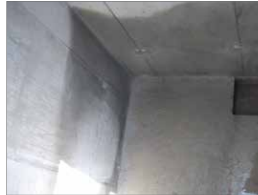
Fot. 7 | Gromadzenie się wody w szybach windowych itp. najniżej położonych elementach obiektu to typowe efekty zarówno błędnej koncepcji, jak i błędów wykonawczych (fot. autor)
