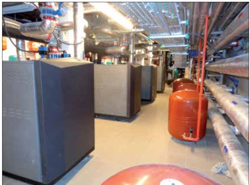
Fot. 2 | Węzeł ciepły z pompami ciepła (fot. autora)
