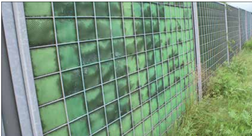
Fot. 8 | Przykład degradacji siatki polietylenowej pod wpływem promieniowania UV po trzech miesiącach użytkowania
