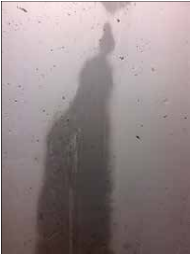
Fot. 4 | Ściana garażu podziemnego. Przeciek przez rysę (fot. autor)
