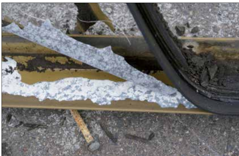
Fot. 2 | Korozja szczelinowa między źle dopasowaną uszczelką a ramą ekranu
