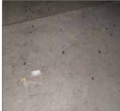
Fot. 7 | Włókna stalowe na powierzchni posadzki
