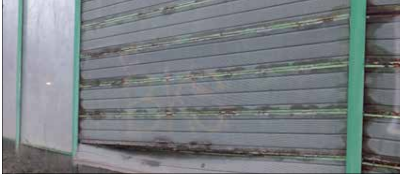
Fot. 14 | Całkowita degradacja ekranów przy drodze krajowej
