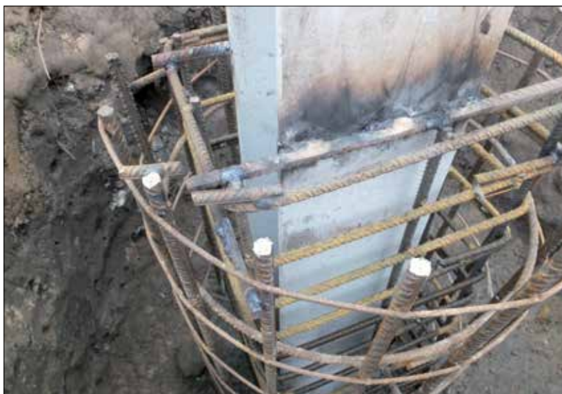
Fot. 3 | Połączenie zbrojenia z czarnej stali z ocynkowanym słupem powodujące powstanie ogniwa galwanicznego
