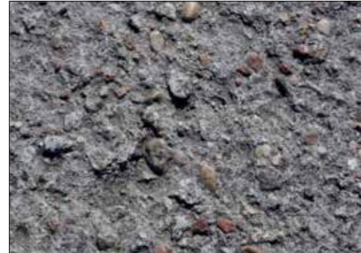
Fot. 8 | Powierzchniowa struktura betonu zdegradowana korozją mrozową
