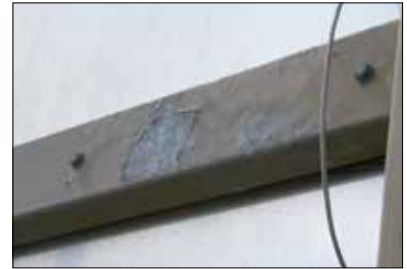
Fot. 13 | Rozległe uszkodzenia korozyjne spowodowane pod wpływem elektrolitu w obszarze uszkodzeń powłok antykorozyjnych powstałych podczas nieuważnego dokręcania śrub
