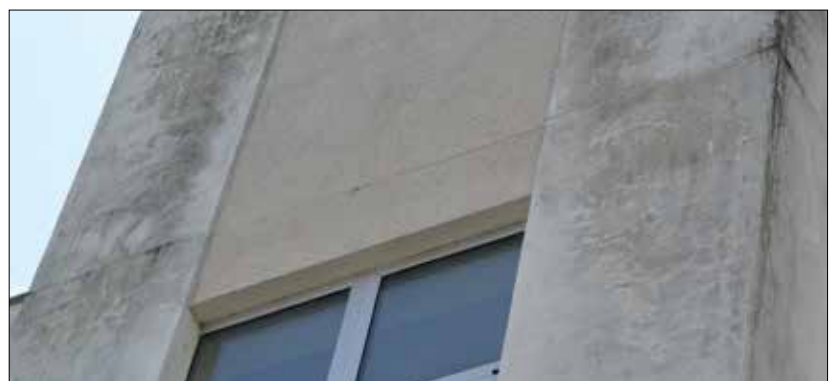
Fot. 1 | Pozioma rysa w attyce powstała na skutek nadmiernych naprężeń termicznych (fot. archiwum autorów)
