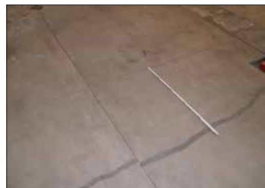
Fot. 2 | Zarysowanie i pęknięcia posadzki
