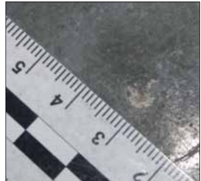
Fot. 5 | Odprysk posadzki spowodowany reakcją alkaliczną kruszywa betonu z cementem
