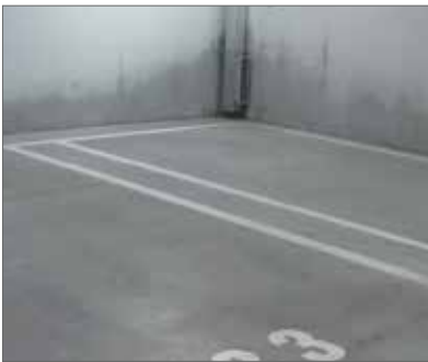
Fot. 5 | Garaż podziemny. Przeciek w strefie połączenia płyty dennej ze ścianą. Typowy skutek błędów projektowych i/lub wykonawczych konstrukcji typu biała wanna (fot. autor)
