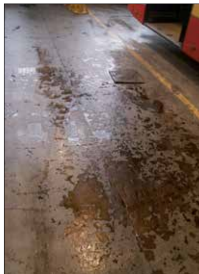
Fot. 11 | Intensywnie wytarta nawierzchnia w zajezdni autobusowej
