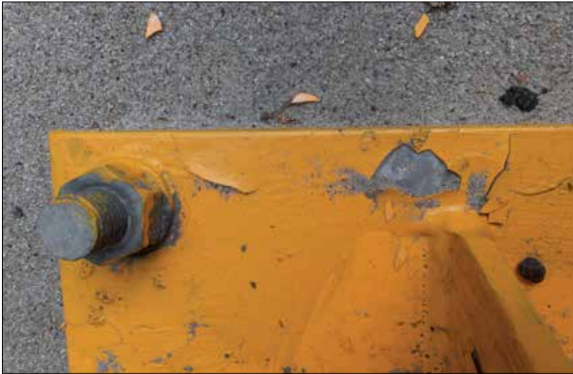
Fot. 11 | Przykład niewłaściwie wykonanych napraw zabezpieczeń antykorozyjnych
