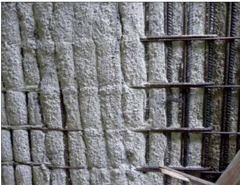
Fot. 1 | Brak otulenia zbrojenia spowodowany zbyt gęstą mieszanką betonową
