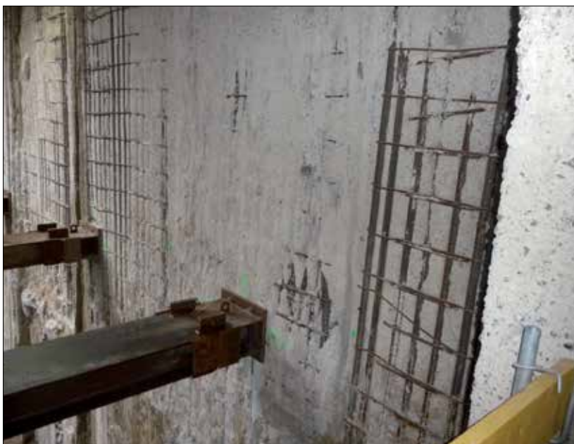
Fot. 2 | Brak otulenia zbrojenia betonem w pobliżu styków sekcji
