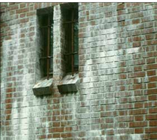
Fot. 5 | Charakterystyczne wykwyty wapna z zaprawy cementowej na murze ceglanym
