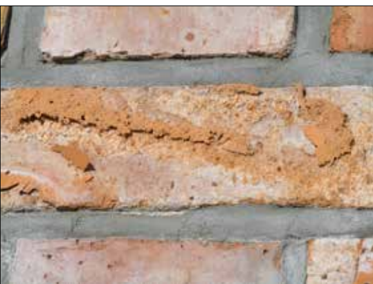
Fot. 4 | Zniszczenia wywołane użyciem zapraw cementowych do spoinowania. Widoczne na licu cegły wykwyty związków soli oraz początek procesu łuszczenia się lica cegły, przy czym spoina cementowa jest nienaruszona
