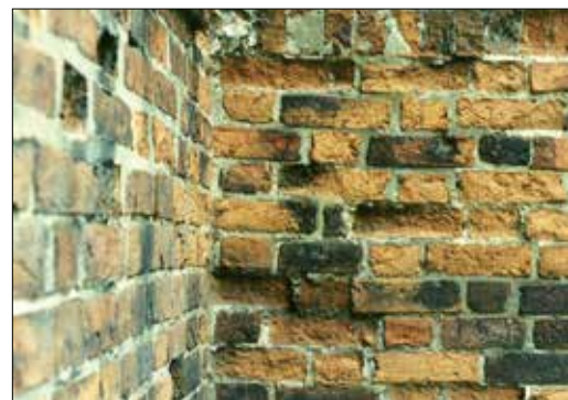
Fot. 2 | Zniszczenia wywołane przez zbyt szczelne i za mocne zaprawy użyte do porowatej cegły. Duże i głębokie ubytki lica wątku muru, a wokół nienaruszona cementowa spoina
