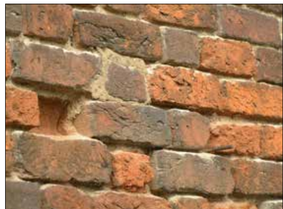
Fot. 3 | Wyplukane zaprawy wapienne w wątku ceglanym. Skutek działania warunków zewnętrznych na nieodporną zaprawę powietrzną
