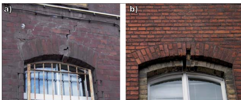
Fot. 1 | Przykłady uszkodzeń nadproży łukowych
