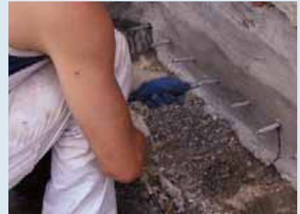
Fot. 1. W murach o wysokim stopniu zawilgocenia zaleca się iniekcje ciśnieniowe
