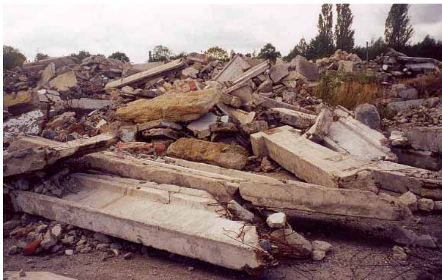
Fot. 1. Niewłaściwa rozbiórka
