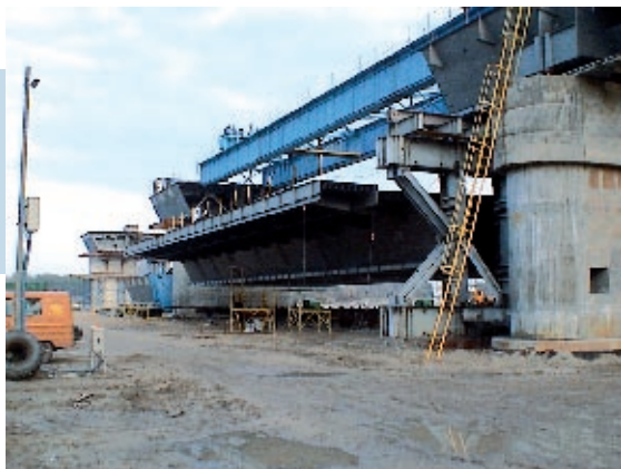
Fot. 3. Scalony fragment przęsła o długości 54 m i masie 560 Mg przygotowany do podnoszenia (fot. A. Berger)
