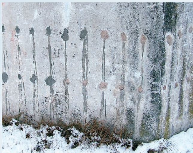
Fot. 2. Zastosowanie iniekcji dwurzędowej – zły rozstaw otworów. Zdjęcie przedstawia ścianę z widocznymi pionowymi otworami iniekcji, które są zbyt blisko siebie rozmieszczone, co może skutkować niepełnym osuszeniem muru.
