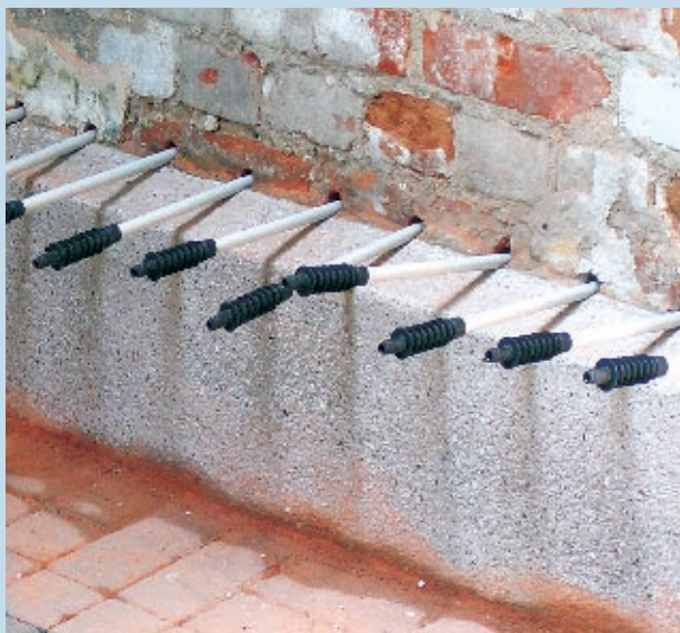
Fot. 5. Brak równoległości odwiertów
