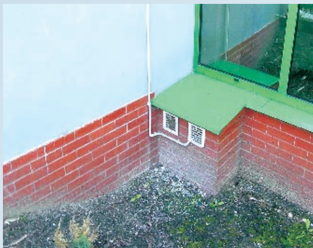
Fot. 1. Błędna profilacja terenu – spadek w kierunku budynku
