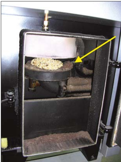
Fot. 6. Widok wnętrza kotła na pellety (widoczna taca palnika z paliwem)
