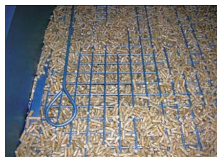
Fot. 4. Pellety, ale już w kotle, ściślej w zbiorniku kotłowym
