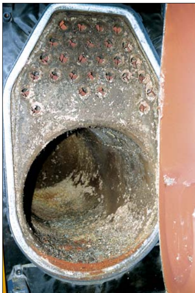
Fot. 7. Widok wnętrza kotła olejowego po sezonie grzewczym
