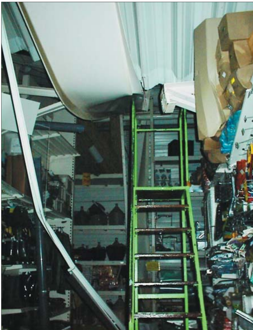
Sztywna podpora ramy doznała wychylenia z płaszczyzny ściany z osi F w kierunku do wnętrza budynku. Płatwie kratowe pomiędzy osiami F i E sunęły się do rygła, zrywając równocześnie śruby łączące je z blachami węzłowymi na ryglu. Uszkodzona konstrukcja oparła się na sztywnych regałach do składowania towaru. Na zdjęciu: widoczne odkształcenia elementów dachu
