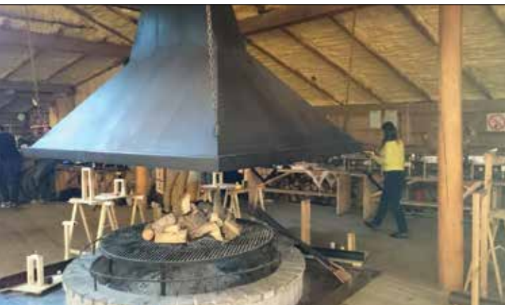
Fot. 1 | Otwarte palenisko
