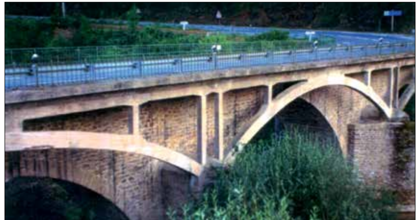
Fot. 1 | Most w Tanus w południowej Francji – żelbetowy ramoluk jest ażurowy i nie przesłania istniejącej starej konstrukcji, ale silnie z nią kontrastuje (wariant A – tabl. 1)
