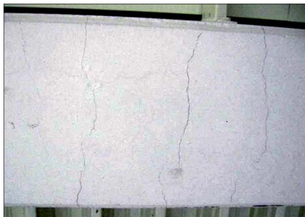
Fot. 12 | Zarysowania skurczowe na powierzchni silnie zbrojonej żelbetowej płaty dachowej
