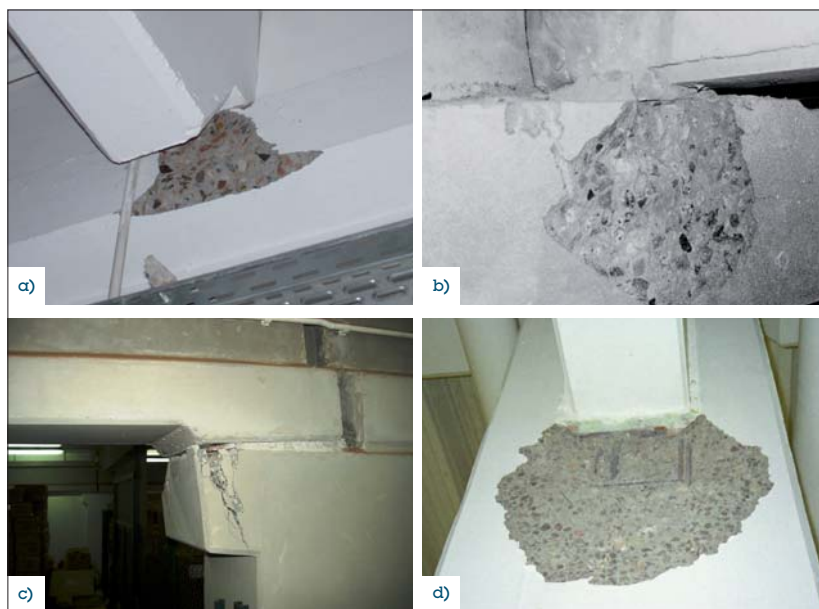
Fot. 6 | Obrazy uszkodzeń stref podporowych: a) oparcie płatwi na dźwigarze, b) oparcie żebra płyty TT na wsporniku belki, c) oparcie dźwigara na wsporniku słupa, d) oparcie dźwigara w widełkowym wycięciu słupa
