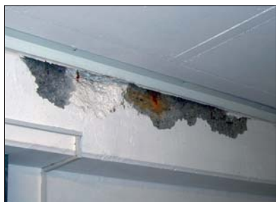
Fot. 7 | Uszkodzenia liniowego wspornika pod oparciem płyt stropowych
