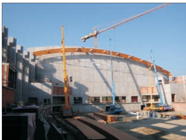
Fot. 7 | Zmontowany dźwigar. Po założeniu płatwi łączących dźwigar ze ścianą szczytową możliwe będzie zluźnienie zawiesi dźwigarów
