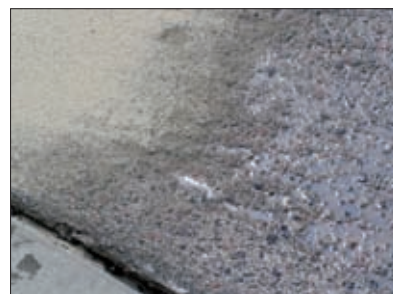
Fot. 2 | DPG Dorohusk. Układana na frezowanym betonie pierwsza warstwa żywicy StoPox IHS-BV z zasypem piaskiem kwarcowym
