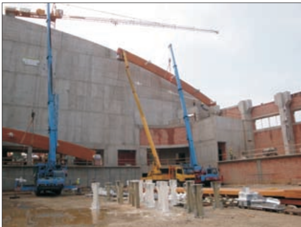
Fot. 3 | Posadowienie pierwszego segmentu dźwigara na niższym słupie, gdzie przewidziano łożysko stałe
