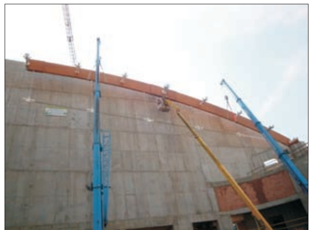
Fot. 6 | Posadowienie trzeciego segmentu dźwigara na łożysku przesuwającym na wyższym słupie hali
