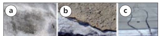
Fot. 8 | Uszkodzenia spowodowane błędami technologicznymi: a) złuszczenia powierzchniowe, b) odspojenie powierzchniowej warstwy naprawczej, c) pęknięcia wywołane punktowym przeszywnieniem nawierzchni
