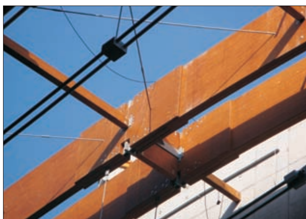
Fot. 8 | Połączenie dwóch dźwigarów z widocznym wzmocnieniem nakładkami ze sklejki typu kerto
