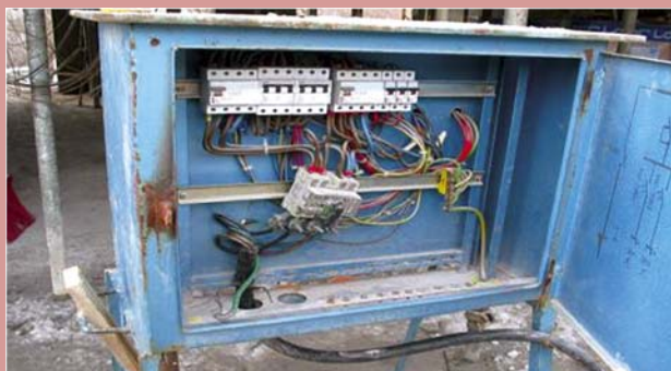
Fot. 5. Niezabezpieczona skrzynka energetyczna (mat. PIP)
