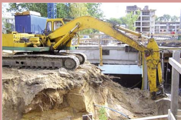
Fot. 4. Brak właściwej odległości pracującego urządzenia od wykopu – zagrożenie obsunięcia gruntu (mat. PIP)
