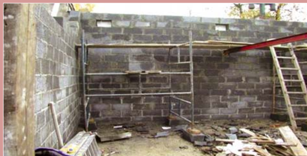
Fot. 1. Brak barier ochronnych, niewłaściwe posadowienie rusztowania, brak bezpiecznej komunikacji, niewystarczająca powierzchnia robocza pomostu (mat. PIP)
