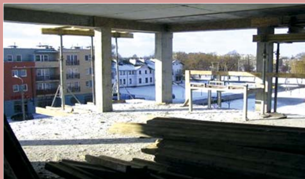
Fot. 2. Brak obarierowania stropu (mat. PIP)
