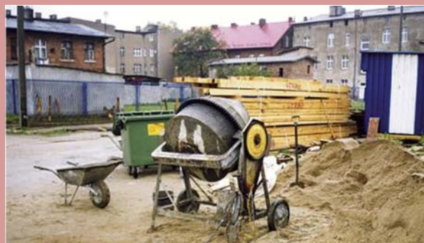
Fot. 6. Niezabezpieczony przewód elektryczny i napęd betoniarki (mat. PIP)
