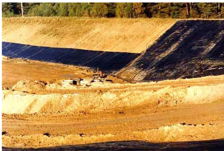
Rys.14. Kradzież pasma geomembrany niezabezpieczonej obsypką
