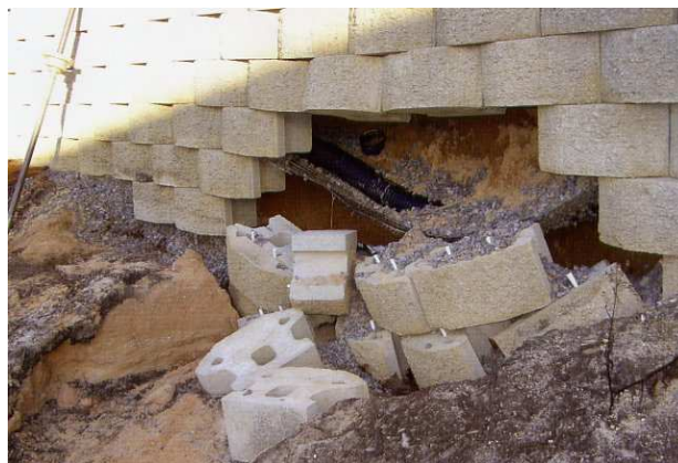
Rys. 35. Awaria części dolnej konstrukcji segmentowego muru oporowego poprzez wyflukanie materiału ziarnistego
