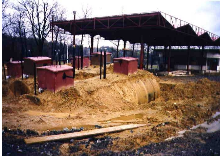
Rys. 12. Wypór zbiorników z wadliwie uszczelnionego wykopu poprzez przedostanie się wody gruntowej
