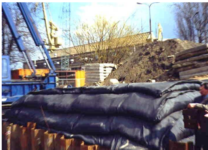
Rys. 29. Przykład źle wykonanej konstrukcji muru zbrojonego bez szalowania i formowania części czołowej przeznaczony do poprawy
