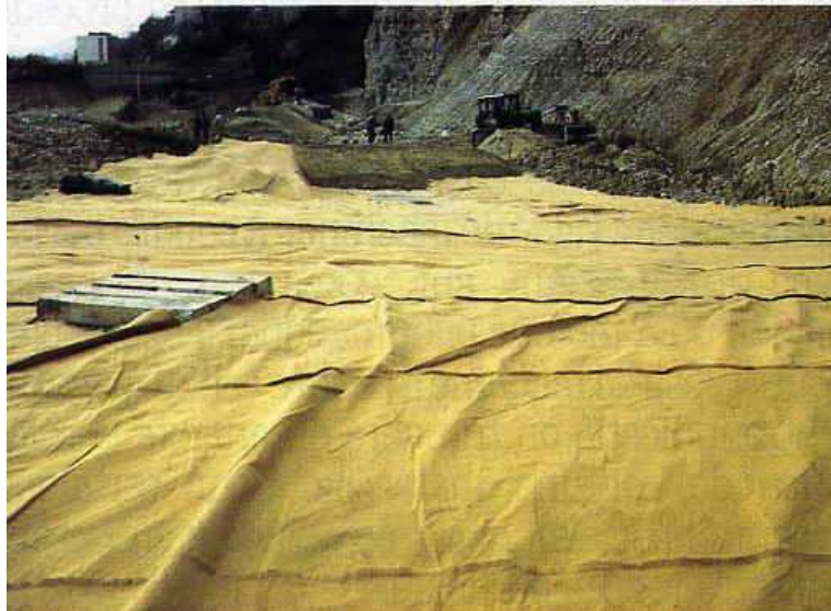
Rys. 41. Pofałdowane płaszczyzny geotkaniny nie gwarantują dobrej współpracy z gruntem
