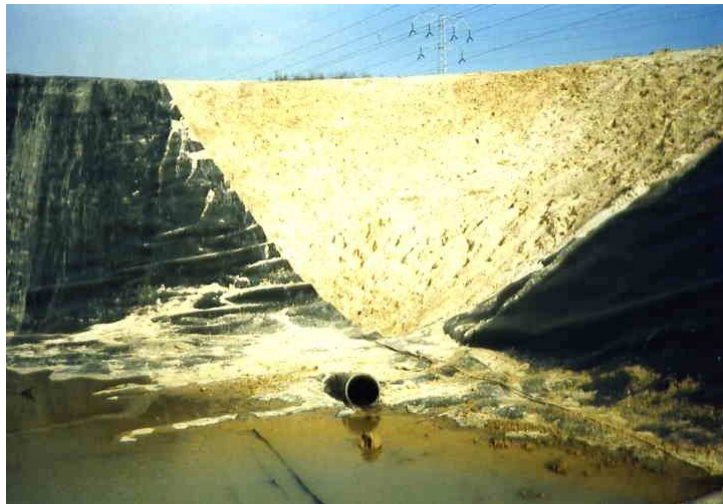
Rys.13. Zbyt wysoko osadzona rura do odprowadzania odcieków z dna składowiska
